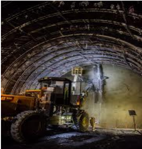
Figure II.5 : Béton projeté seul
