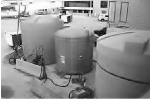
Réservoirs en fibre de verre dans un aéroport
