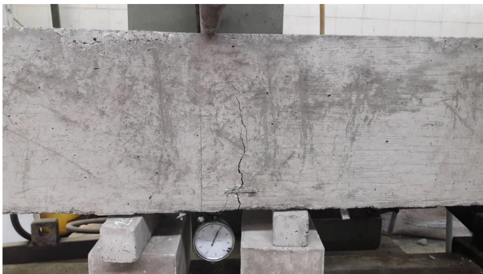
Figure III 23 Mode de fissuration de la poutre en béton fibré (apparitions de la fissure)
