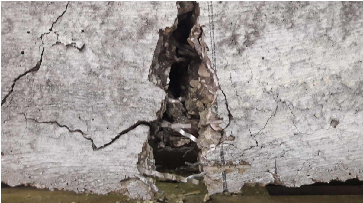
Figure III 34 mode de rupture de la poutre béton fibré et ferrillé
