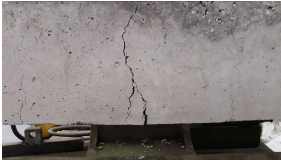
Figure III 11. Mode de fissuration de la poutre BT
