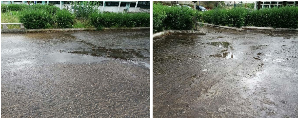
Figure 1 : Stagnation des eaux de pluie sur une surface de béton
