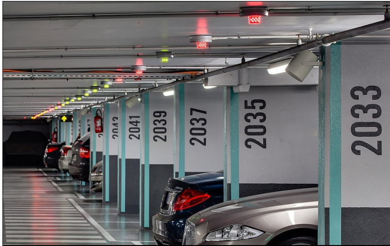
Figure 8: guidage à la place disponible par indicateurs lumineux.
