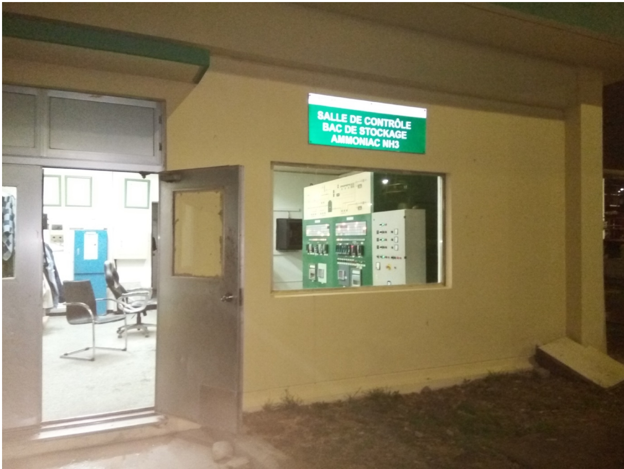
Figure.III.13 Salle de contrôle du bac de stockage d'ammoniac
