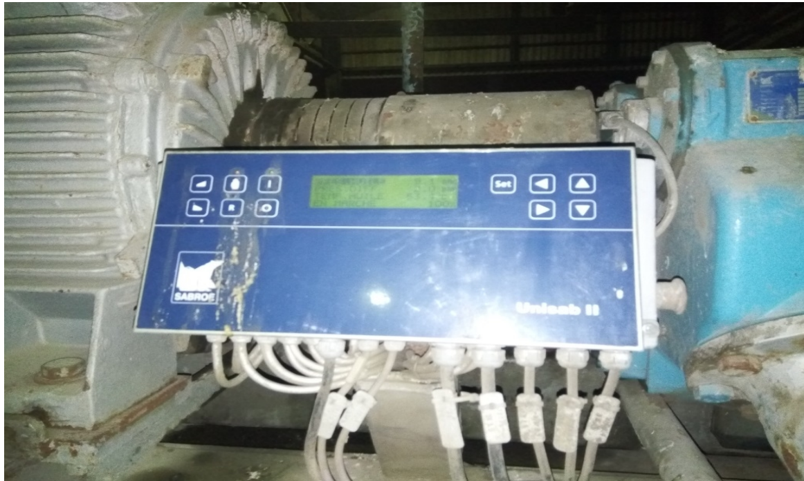
Figure.IV.16 Panneau de commande de compresseur et fonctions d'alarme
