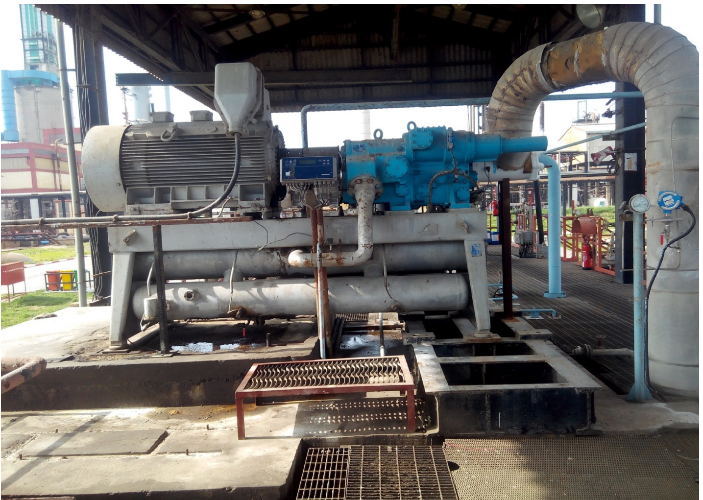
Figure.IV.7 Groupe de compresseur K101 A
