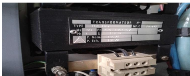
Figure II.24 : Transformateur de courant dans l'armoire électrique.
