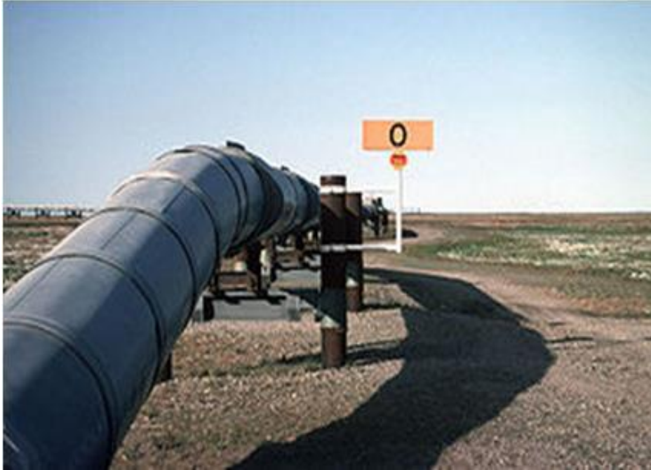
Figure I.5 :Pipeline dans l'environnement
