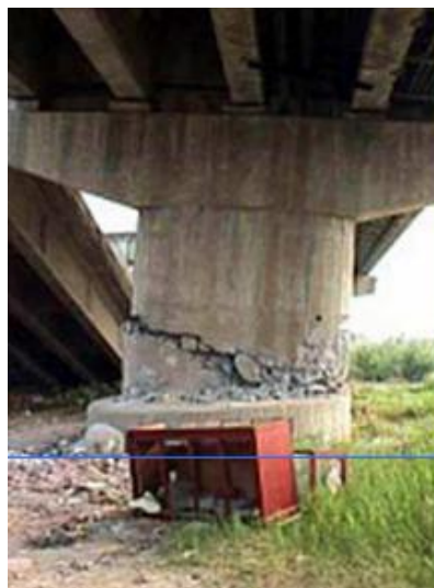
Figure 2 : Rupture d'un autopont lors d'un tremblement de terre.
