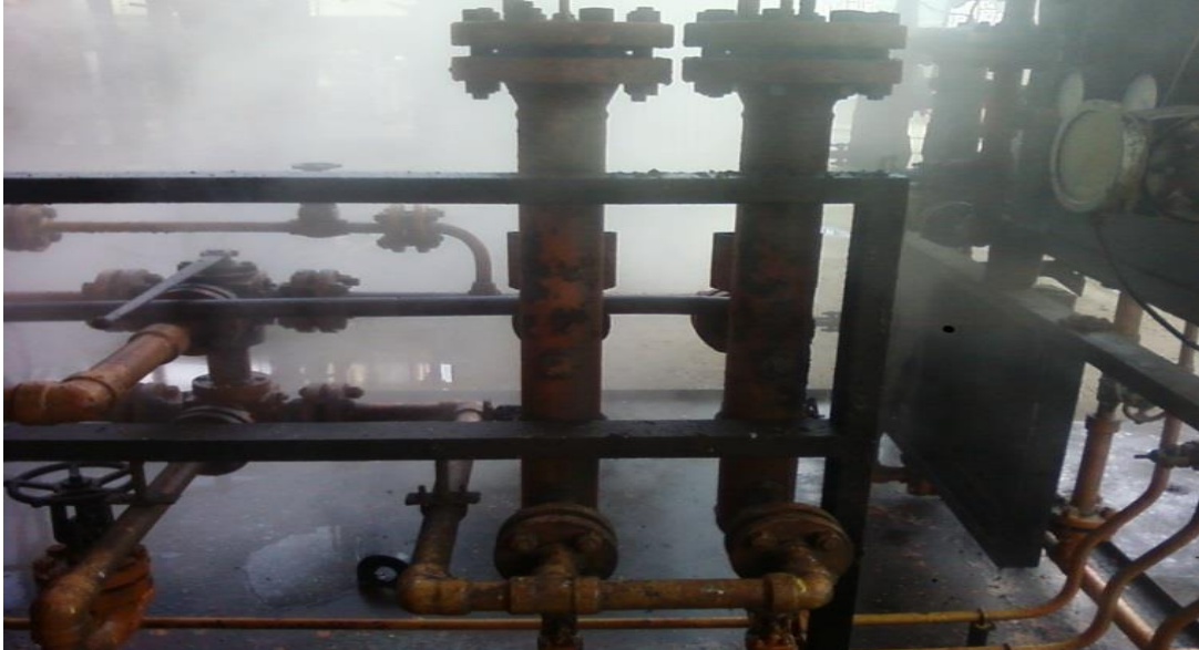
Figure III.16: filtres d'huile d'étanchéité
