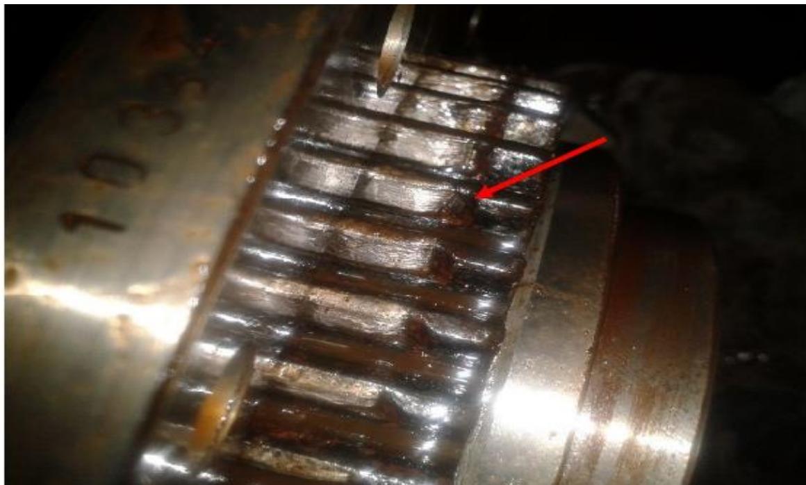
FigureIV.4: Manchon de l'accouplement cote turbine
