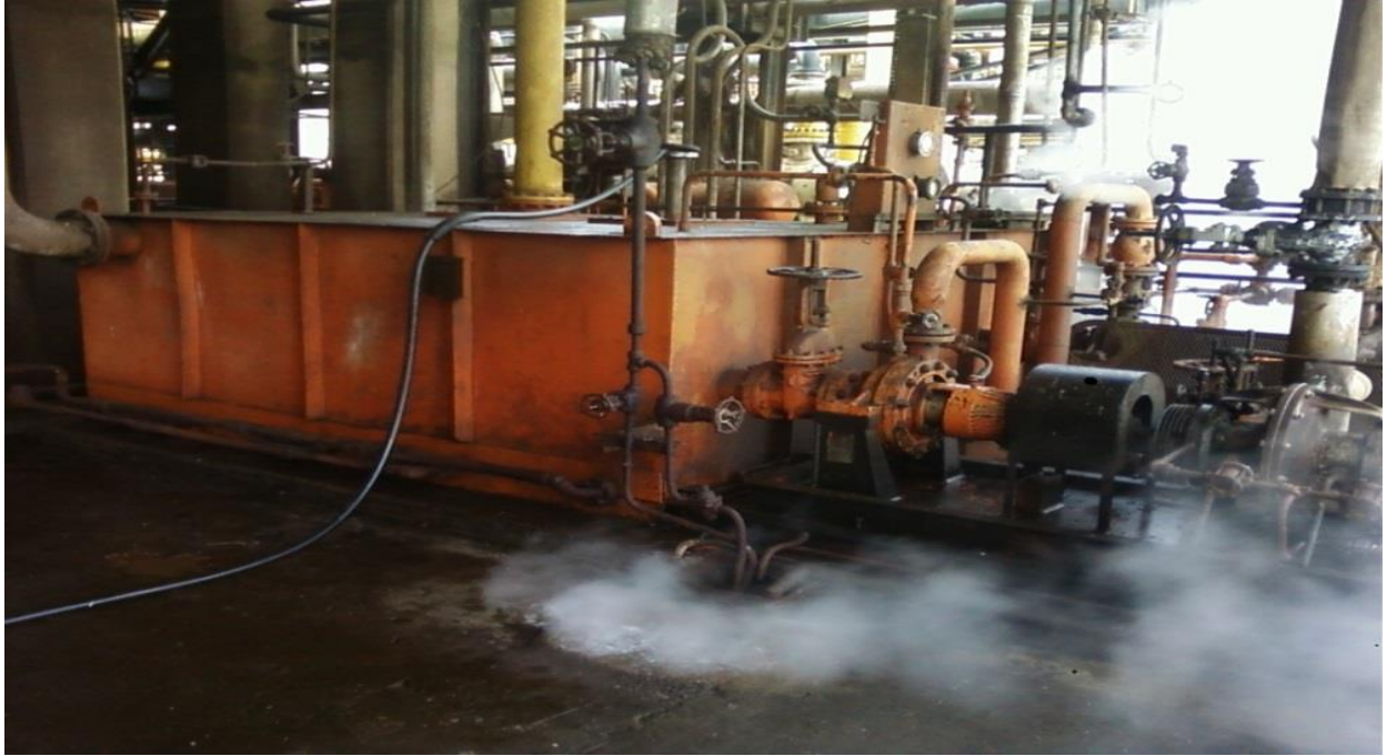
Figure III.10 : réservoir de stockage d'huile
