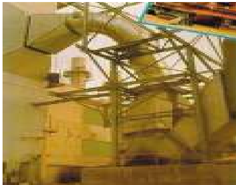
Fig.II.8 : ventilateur de cimenterie
