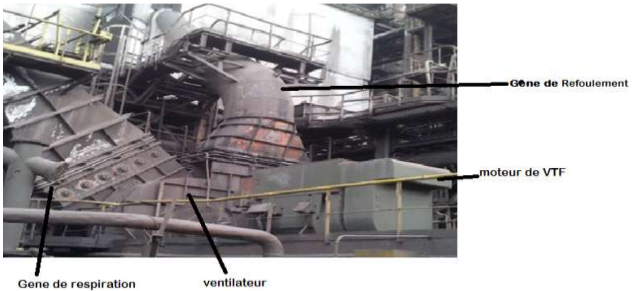
Fig.II.18 : vue générale de l'installation (VTF)
