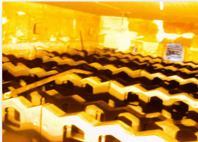
Figure 20: Table à longerons, fixes et mobiles en acier réfractaire moulé (intérieur du four)
