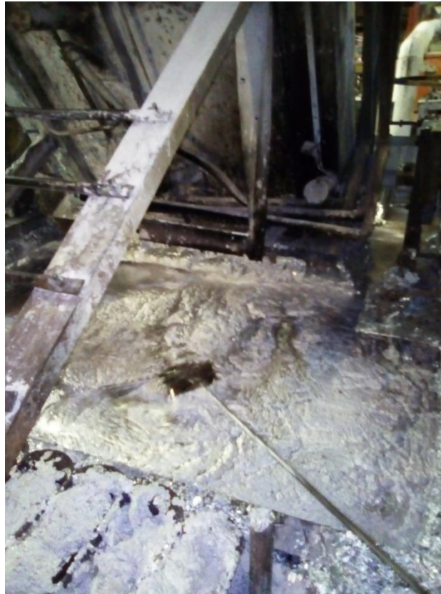
Fig. IV.24: Matte en surface dans le bain zinc
