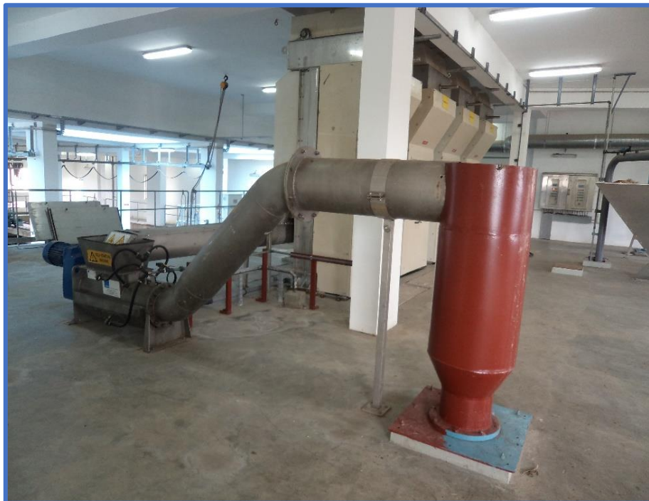
Photographie 2. 2 : Poste de dégrillage
