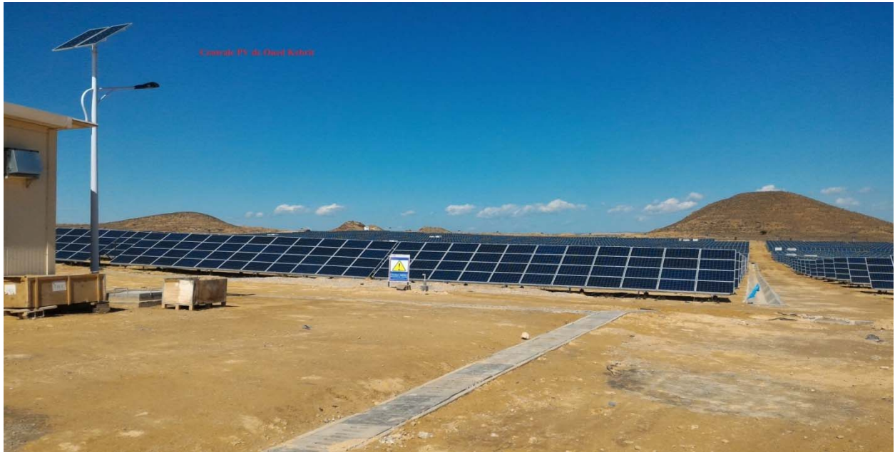
Figure N° (4-2) : Présente les panneaux photovoltaïques de la centrale OUED KEBRIT.
