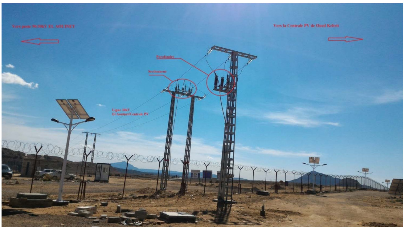
Figure2-7 : présente la sortie de la ligne 30kV de la centrale OUED KEBRIT vers le poste EL AOUINET.
