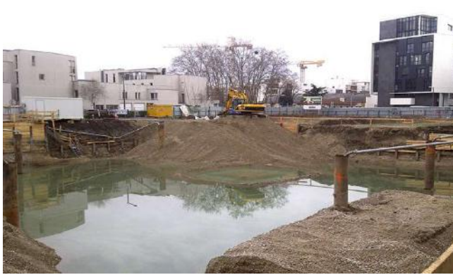
Figure 1.3 Pompage à l'arrêt
