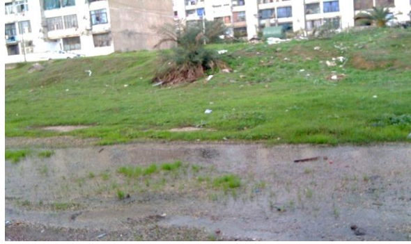
Figure IV.18 : UV2 des fuites dans le réseau d'assainissement au niveau du réseau d'AEP.
