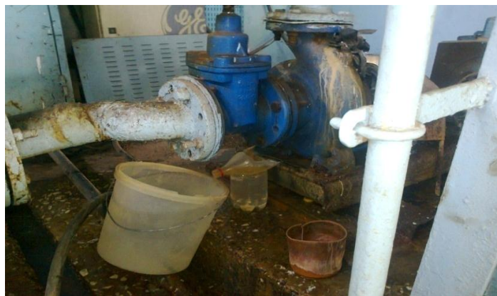
Figure IV.3: Fuites dans la station
