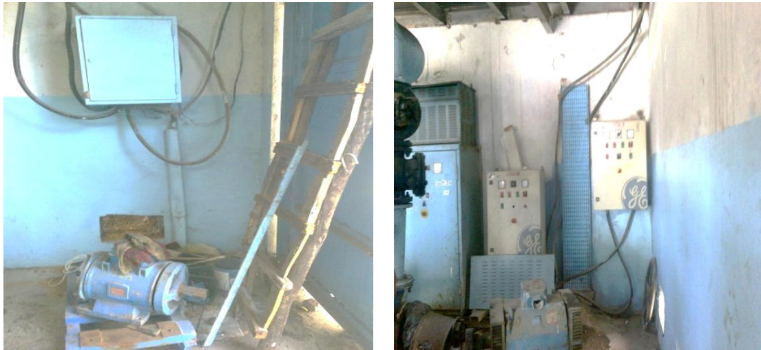
Figure IV.5: Les armoires électriques.
