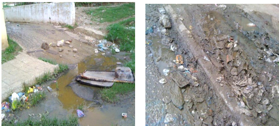
Figure IV.30 : Des fuites considérables en eau potable et des fuites du réseau d'assainissement au voisinage du réseau D'AEP.
