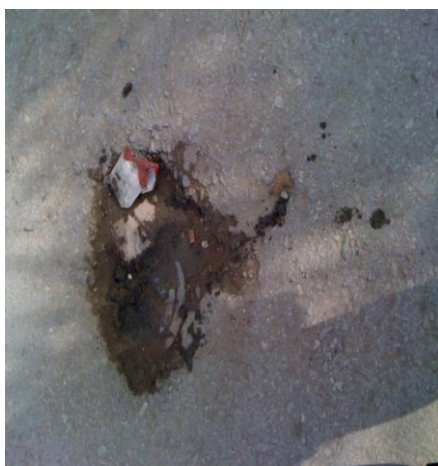
Figure IV.14 : Bouche à clé enterrée
