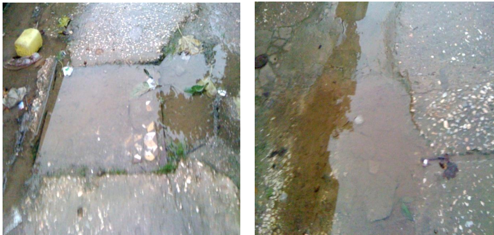
Figure IV.29 : UV 24 des fuites considérables
