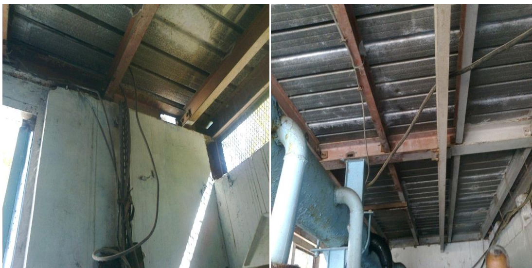
Figure IV.7: La présence de câble électrique sur la porte, et le plafond métallique.
