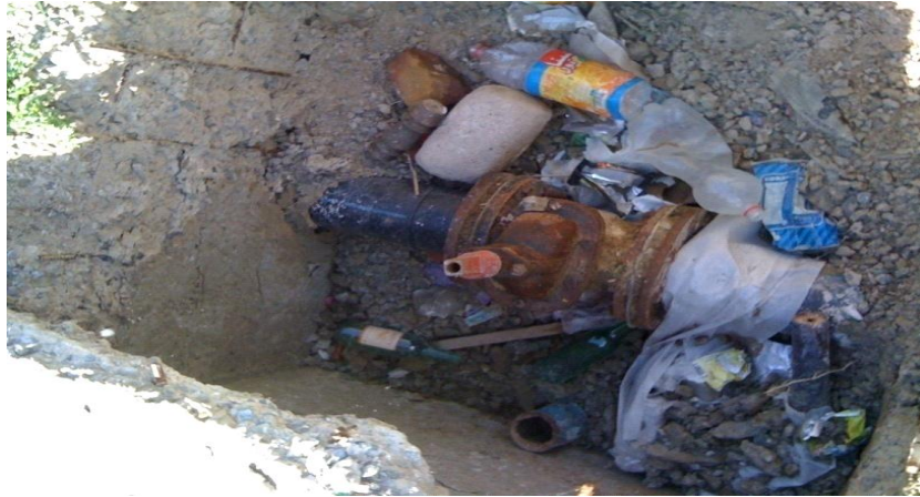
Figure IV.25 : UV 920 L'absence de l'entretien des chambres des vannes.
