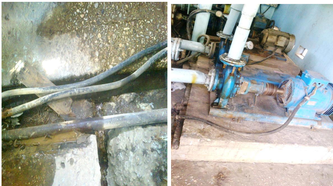
Figure IV.6: Des fuites à l'intérieur de la station au voisinage du câble électrique.
