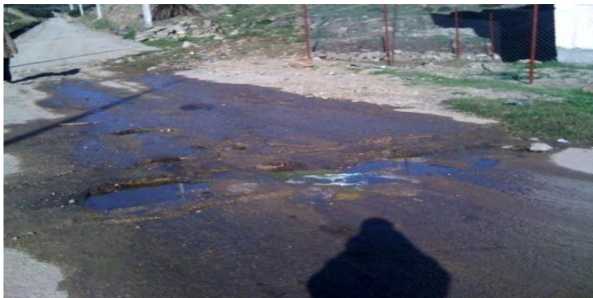
Figure IV.13 : La conduite DN 400 mm en acier, en mauvais état.
