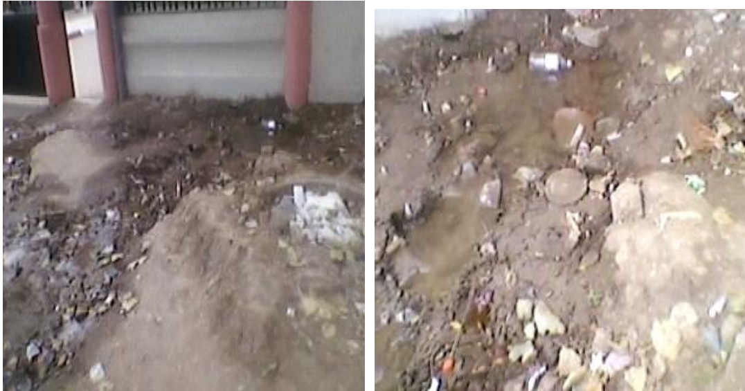
Figure IV.12 : Conduite principale DN 400 mm alimentant Chaiba pleine de fuites.
