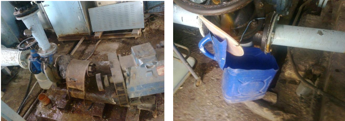
Figure IV.2: Des fuites à l'intérieure de la station au voisinage du câble électrique.
