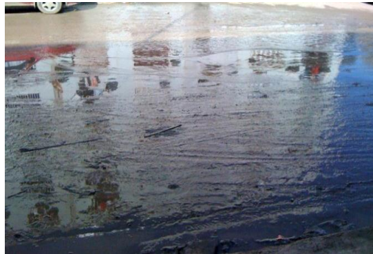
Figure IV.23 : Des fuites en eau potable et des eaux usées au voisinage des conduites d'AEP.
