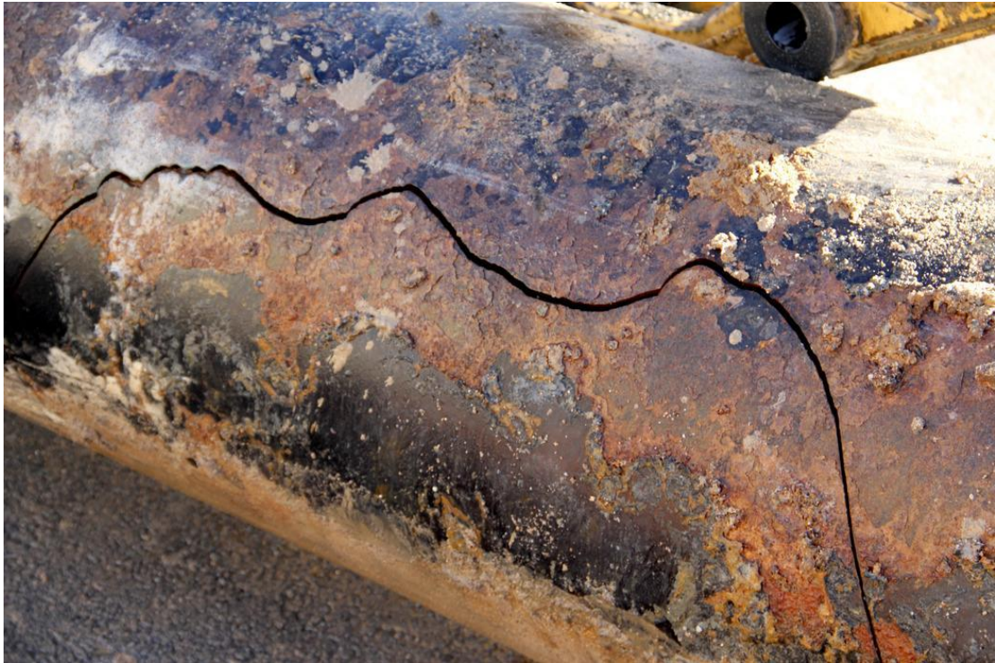
Figure I.5 : Une conduite ayant subi en rupture en fonte [9]
