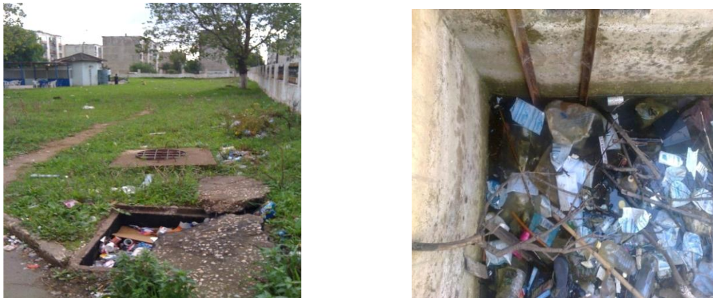
Figure IV.16 : Chambre à vanne pleine d'ordures
