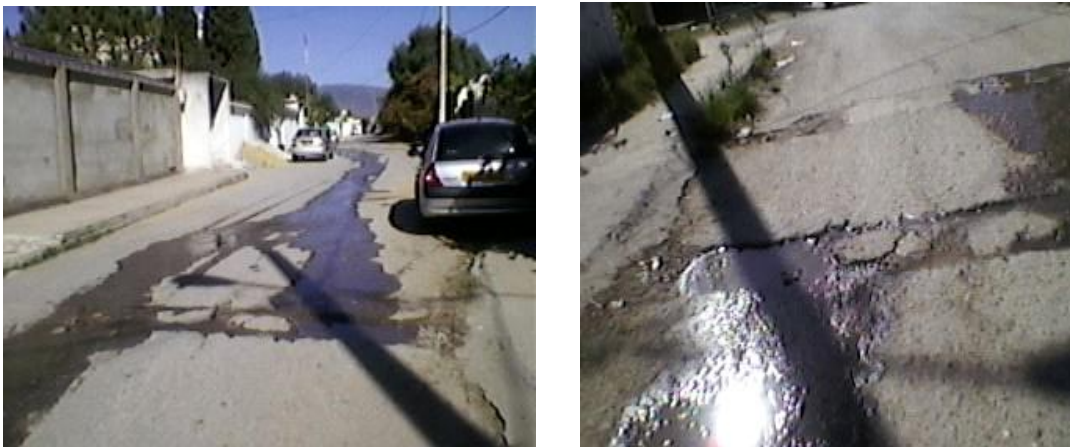
Figure IV.32 : Des fuites considérables des eaux usées et des eaux potables.
