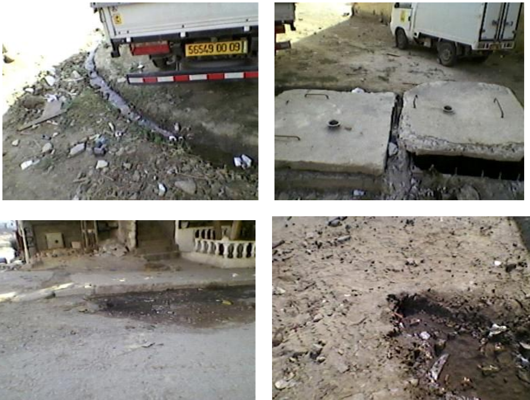
Figure IV.31 : Conduite DN 160 en PVC pleine de fuites.
