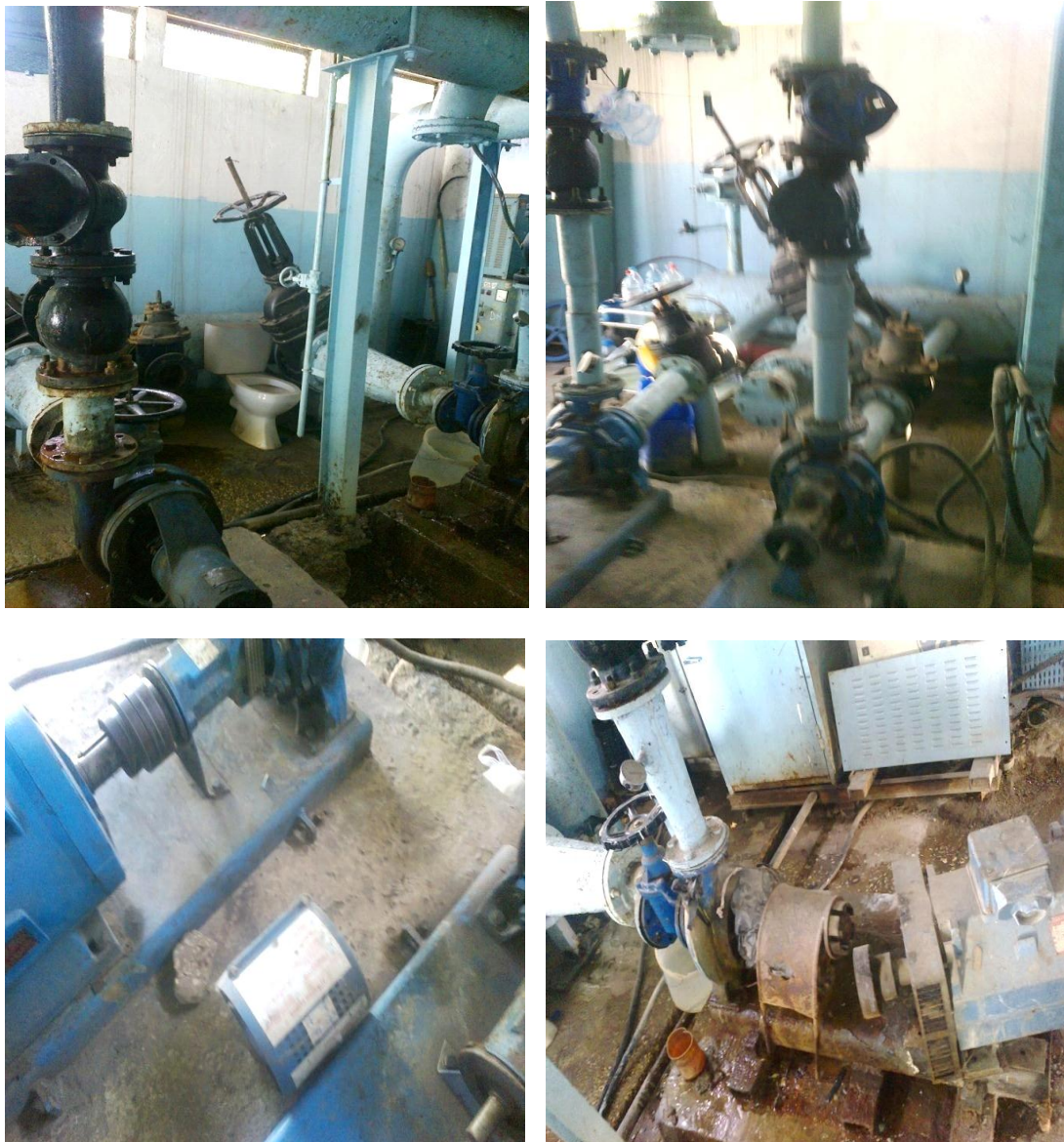
Figure IV.4: Les groupes électropompes de la station SP1.
