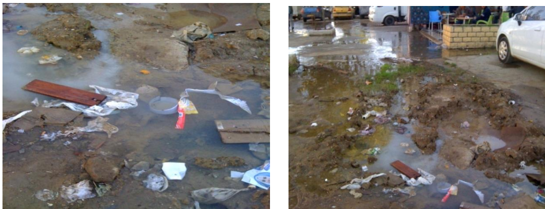
Figure IV.27 : UV 7-8 Conduites de distribution en acier fuis.
