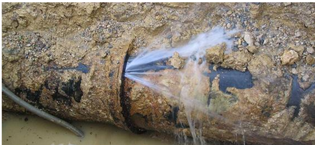
Figure I.3 Fuite dans la conduite a causé Vieillessement des joints [9]
