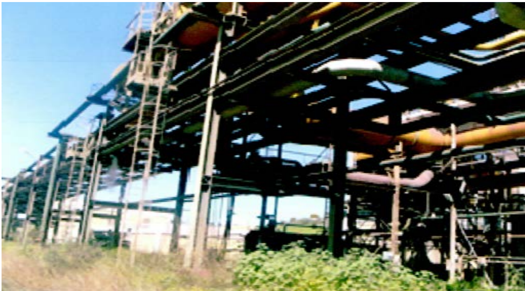
Figure I.2: Racks conduites (vapeur – gaz – eau – air).
