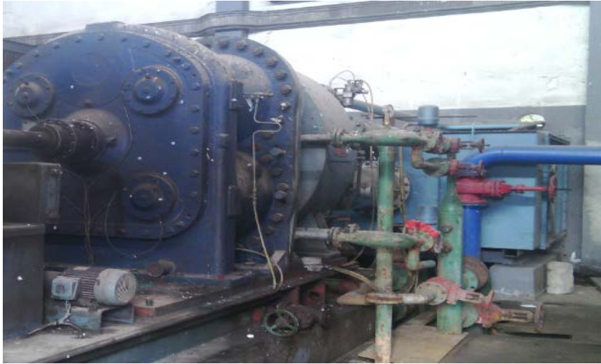
Figure I.15: Compresseur zone Ouest.
