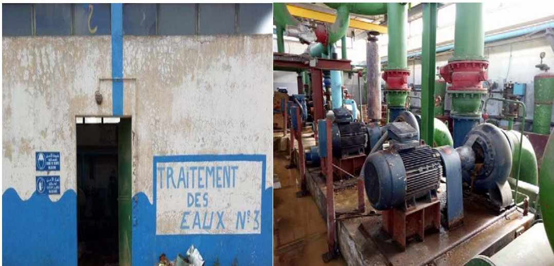
Fig. I.11: Salle de traitement des eaux. Fig. I.12: Intérieure de la salle de traitement
