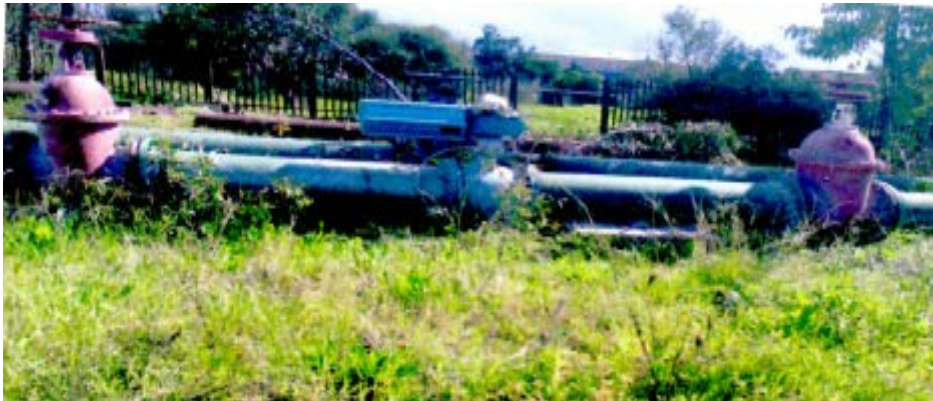
Figure.I.4 : Conduite d'arrivée d'eau.
