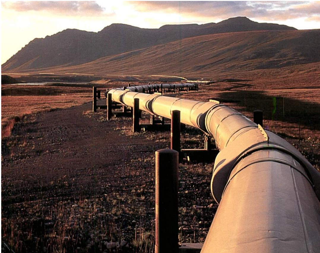
Figure I.1 : Pipeline pour le transport de pétrole [5]
