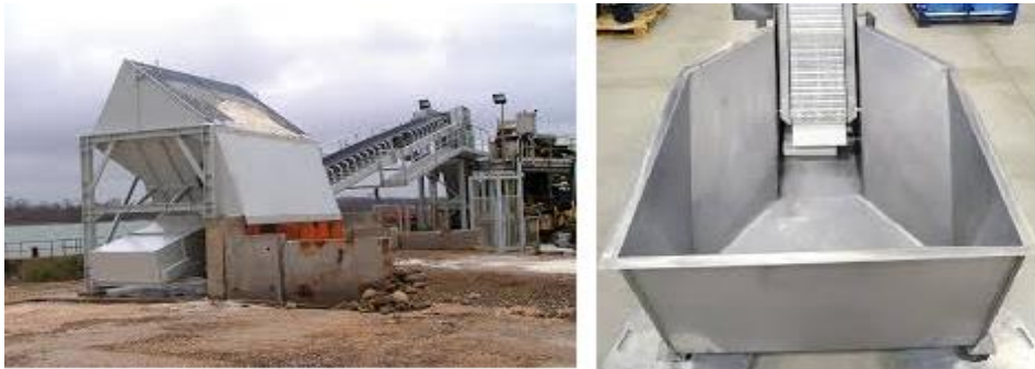
Figure 1.12 Vues de trémie de chargement.
