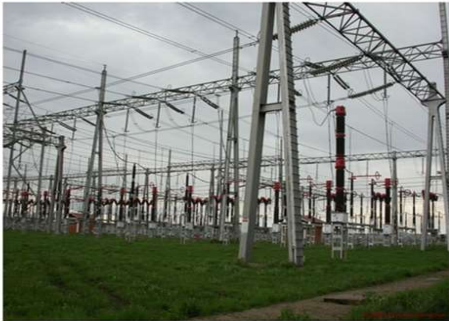
Fig .4. un poste électrique
