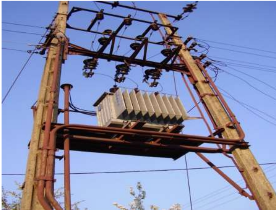
Fig.3. Un Transformateur électrique
