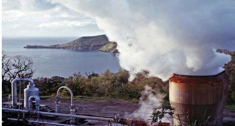
Figure (I-5) : Centrale géothermique
