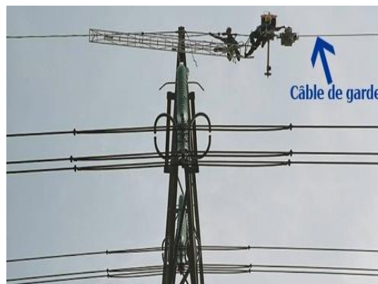
Figure (I-17): câble de garde
