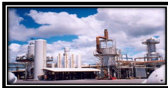
Figure I.2 : Usine H 2 de Guyane au Centre Spatial Guyanais, à Kourou.
