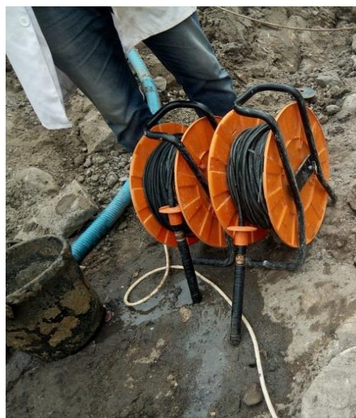
Figure 5-12 : Tourets de câbles
