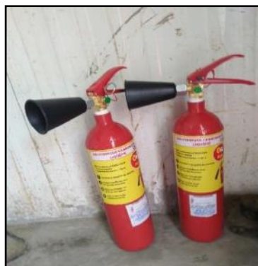
-Figure 8-2: Deux extincteurs-
