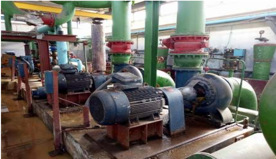
Figure I.16 : La salle de traitement
