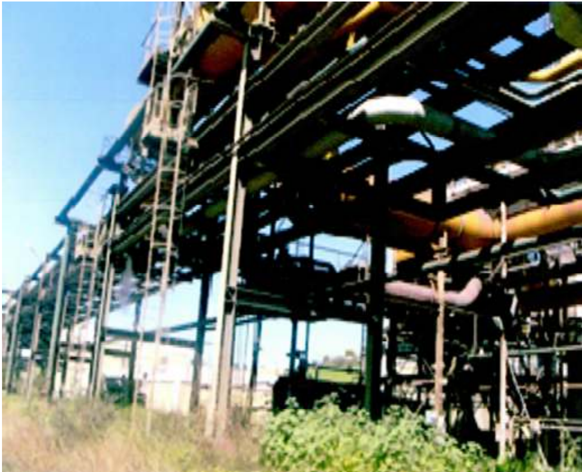
Figure I. 3 : Racks conduites (vapeur – gaz – eau – air).
