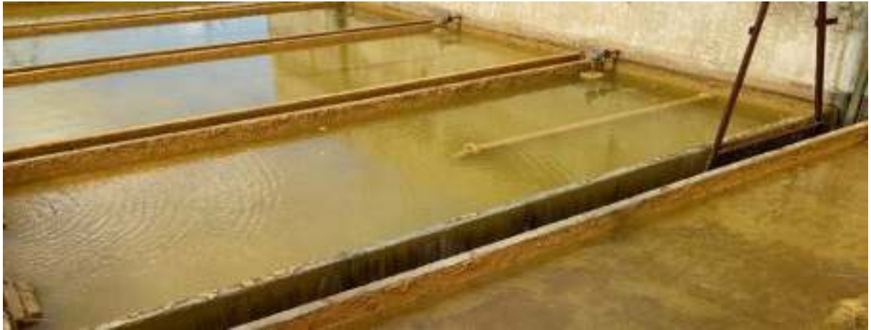
Figure I.14 : Filtre à sable
