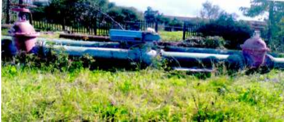
Figure.7 : Conduite d'arrivée d'eau
