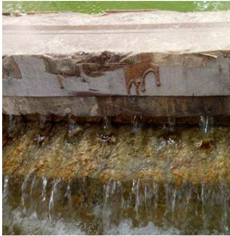
Figure I.13 : Eau débordante du décanteur
