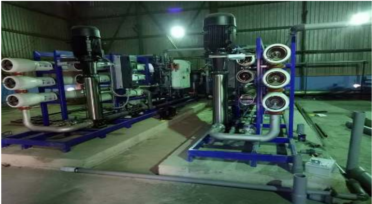
Figure I. 17 : Salle de l'osmose inverse
