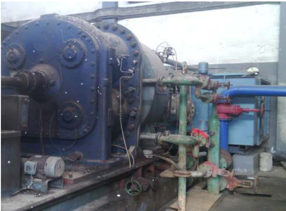
Figure I .19 : Compresseur zone Est
