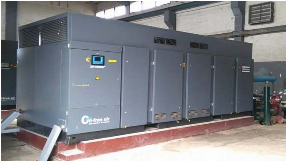
Figure I.20 : Compresseur copo atlas à 3 étages
