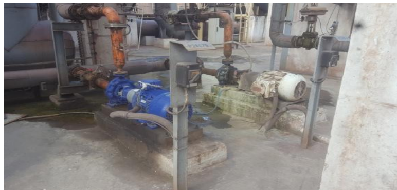
Figure I.9 : les pompes à eau glacé
