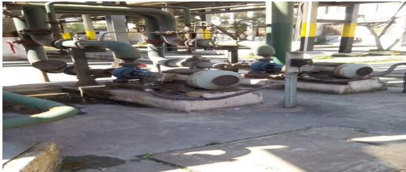
Figure I.8 : les pompes à eau de refroidissement
