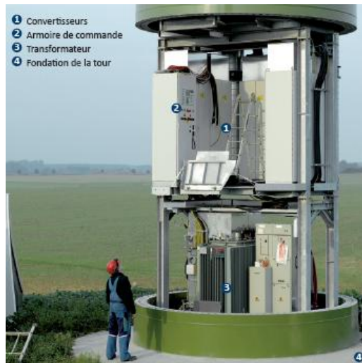
Figure I.13 : Système de contrôle-commande
