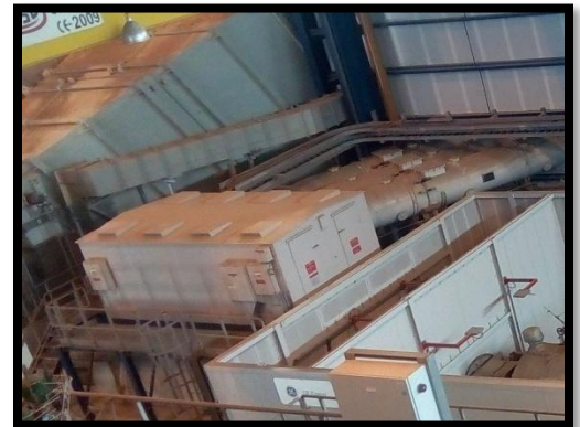
Figure I.8 : photo réelle de L'alternateur (SKD)
