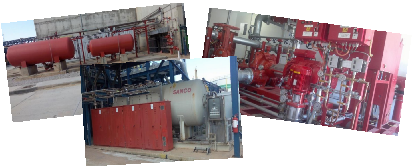
Figure I.13 : photos de système contre incendie (SKD)
