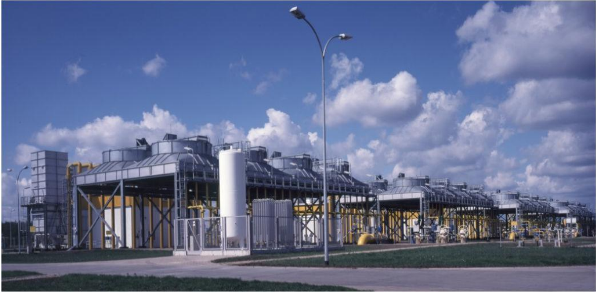
Figure IV.5. Aéro-réfrigérants installés dans une station de compression de gaz naturel [20].
