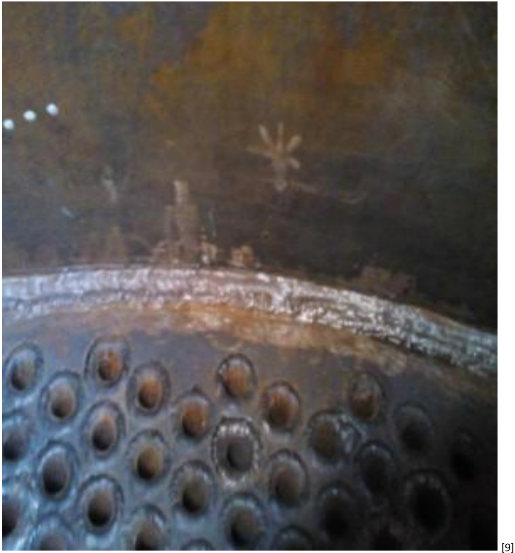
Fig2-12 partie de la Plaque tubulaire supérieure de l'échangeur 123-C
