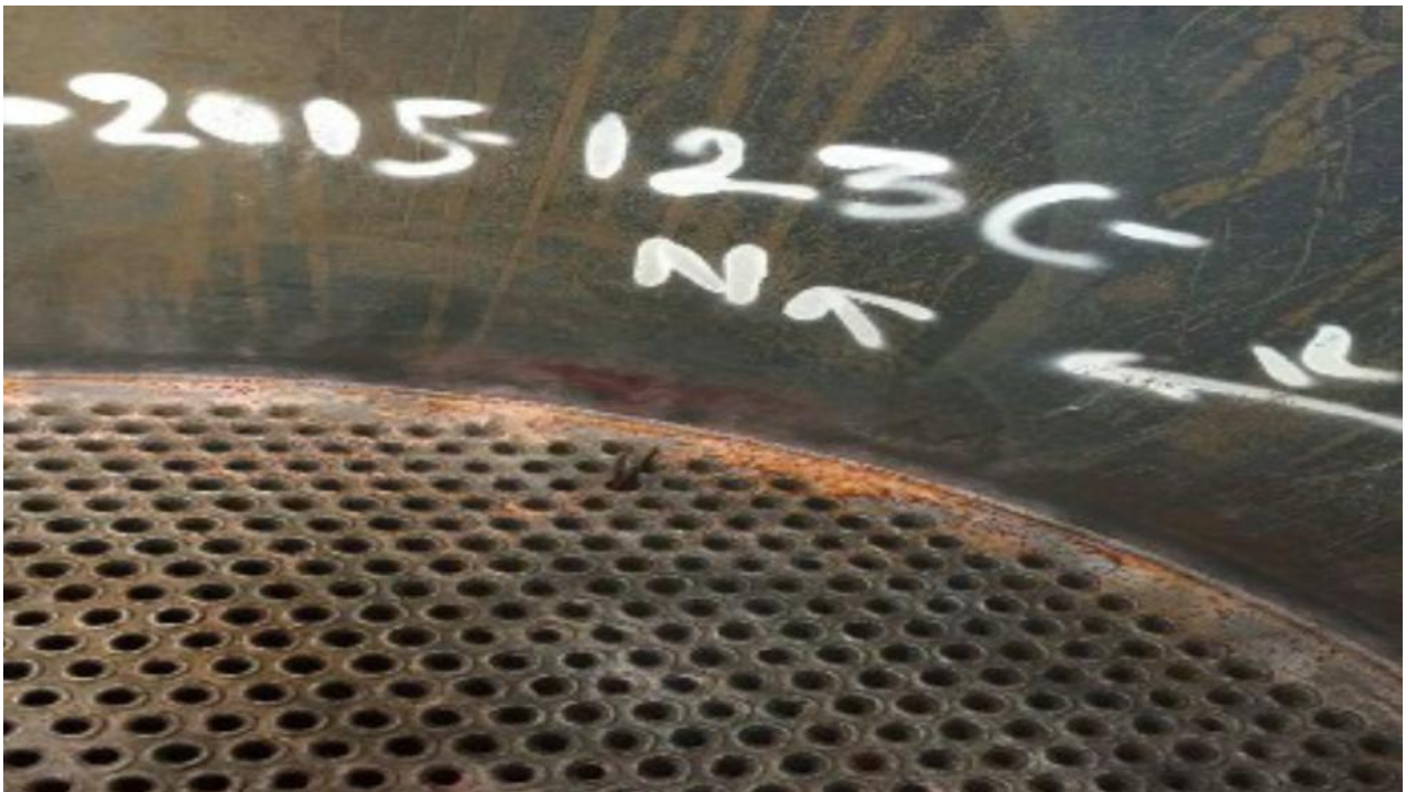
Fig2-14 : la présence de corrosion est claire au niveau des joints de soudure de la plaque tubulaire supérieure avec la virole (boîte de distribution).[9]
