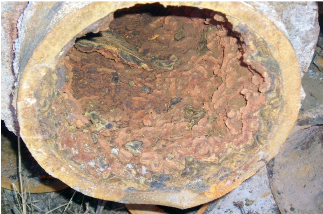
Figure I.1 : Vieillissement des canalisations en fonte [11].
