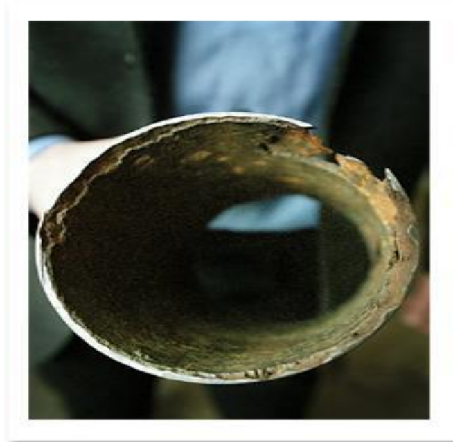
Figure I.2 : Une conduite ayant subi une rupture en Acier [4].
