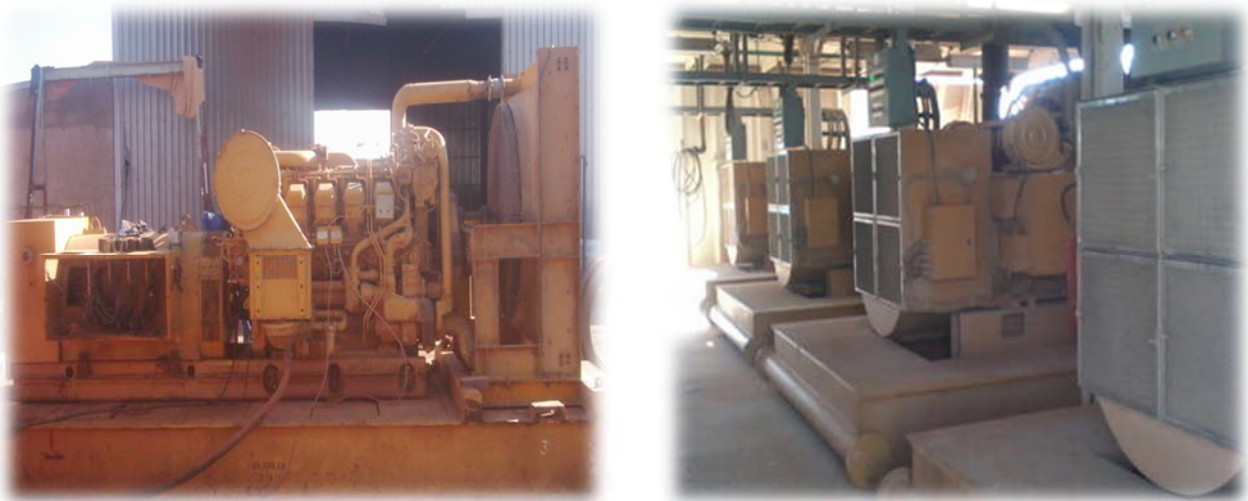
Figure I.15 : les groupes électrogènes de la station TP 127
