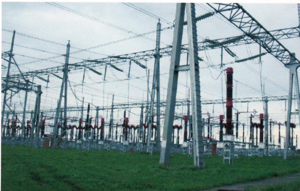
Figure I-4 : Poste électrique haute tension
