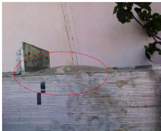
Fig. II.23 : Déformation de la tôle extérieure d'un échangeur de chaleur (Type à plaques brasées)
