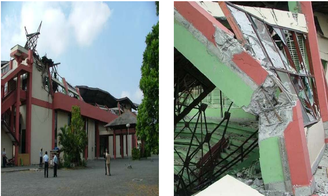
Figure 2.11 Dommages du stade GOR Sport causés par le séisme de Yogyakarta (2006) (Elnashai et al 2006)
