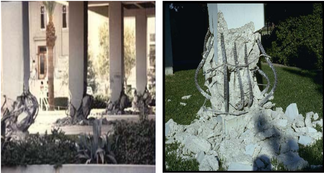
Figure 2.9 Détérioration des poteaux du RDC de l'immeuble des services d'Imperial Valley durant le séisme d'Imperial Valley (1979) (Faison et al 2004).
