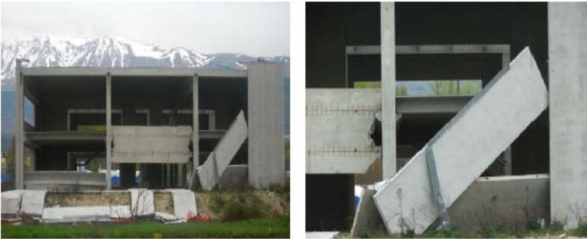
Figure 2.13 Effondrements des structures en béton armé, en maçonnerie, et des éléments non structuraux durant le séisme de L' Aquila (2009) (Di Sarno et al 2011)
