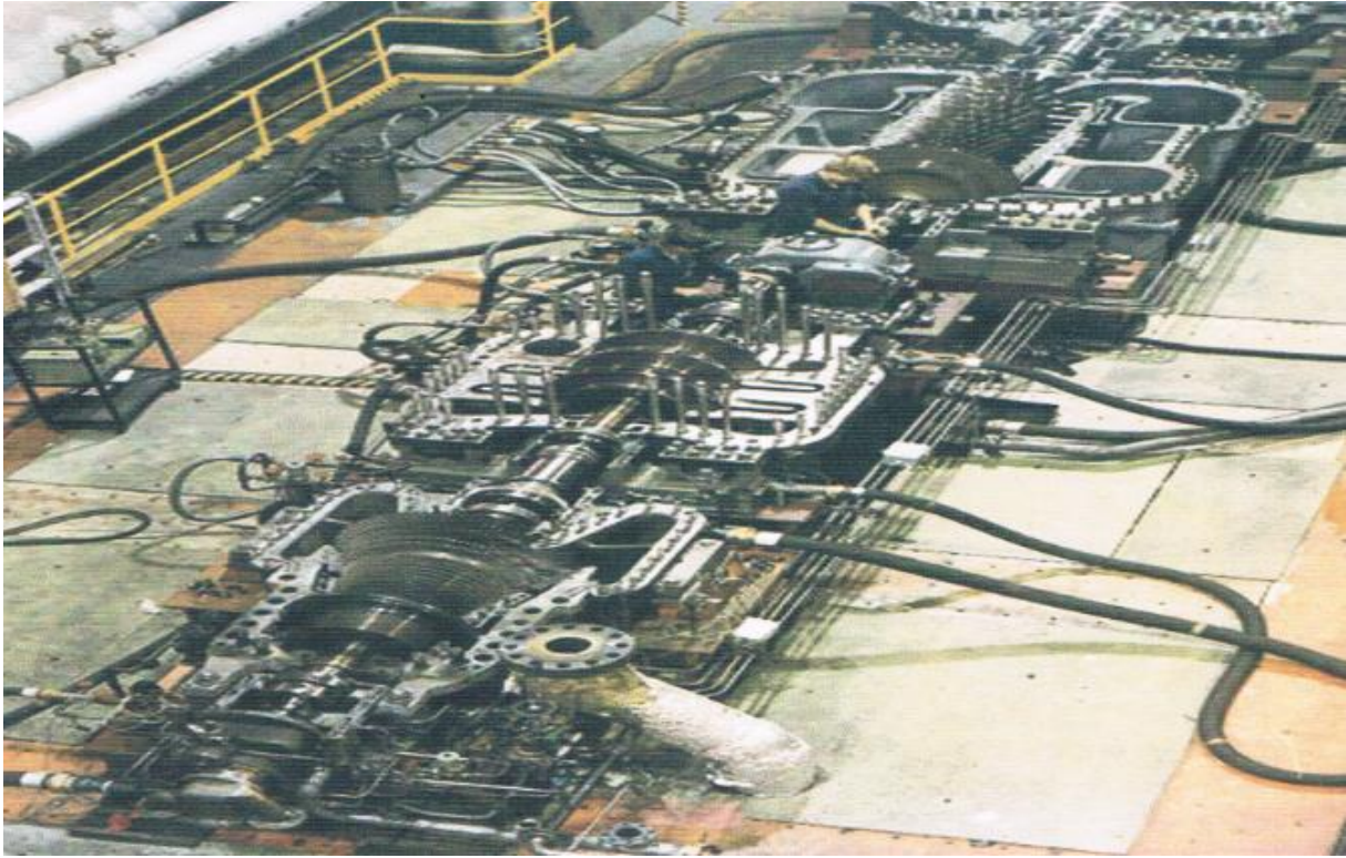
Figure 12 : ensemble (turbine à vapeur + compresseur centrifuge)
