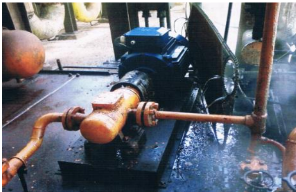
Figure 19 : pompe huile d'étanchéité
