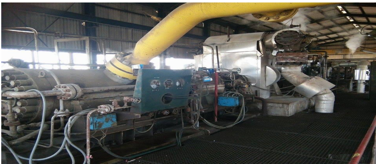
Figure 11 : Vue du turbocompresseur 103-J
