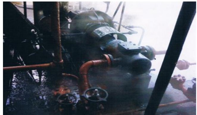
Figure 20 : turbine à vapeur MP
