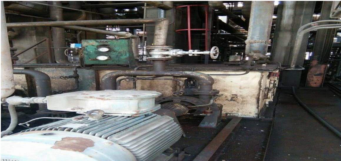
Figure 17 : Réservoir de stockage d'huile
