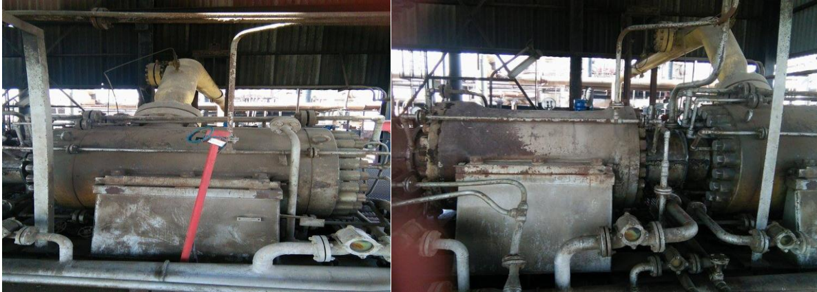
Figure 16 : Photos des compresseur BP et HP.
