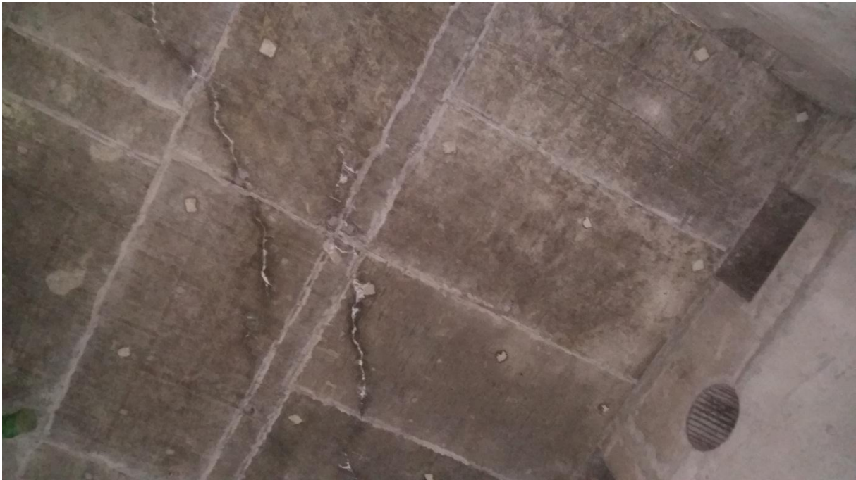
Figure III-a : fissures prélevées sur chantier
